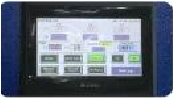
PLC 控制 PLC 控制
